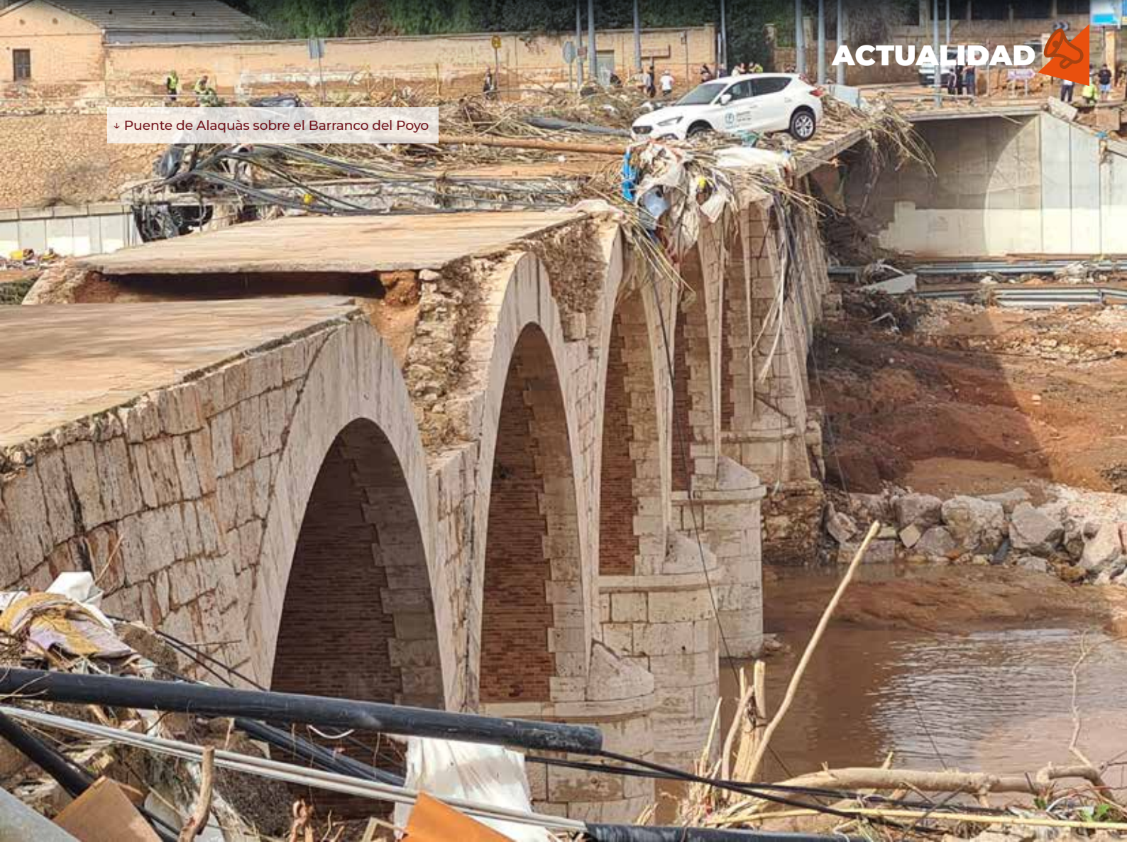
↓ Barranco del Poyo a su paso por Torrent
